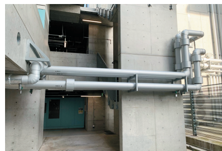
⑤ 建物間熱融通システムの研究 (写真は熱融通システムの配管)
