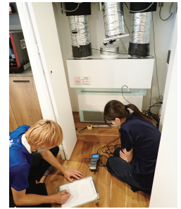
⑩ 全館暖冷房システムの性能評価を行っている
