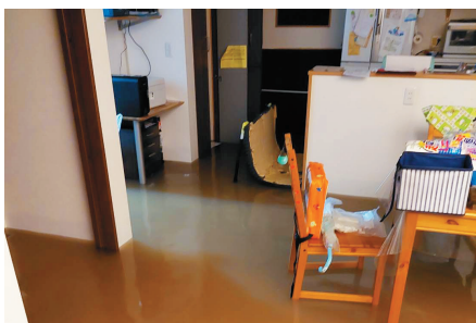
⑤ 浸水被害を受けた室内空間
